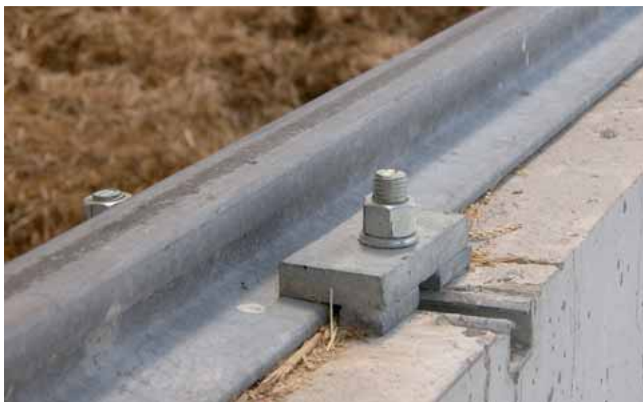
▼ Due dettagli: uno dei bulloni che fissano i binari di scorrimento del carroponete sui due muretti laterali e il fermo corsa a fine vasca.
