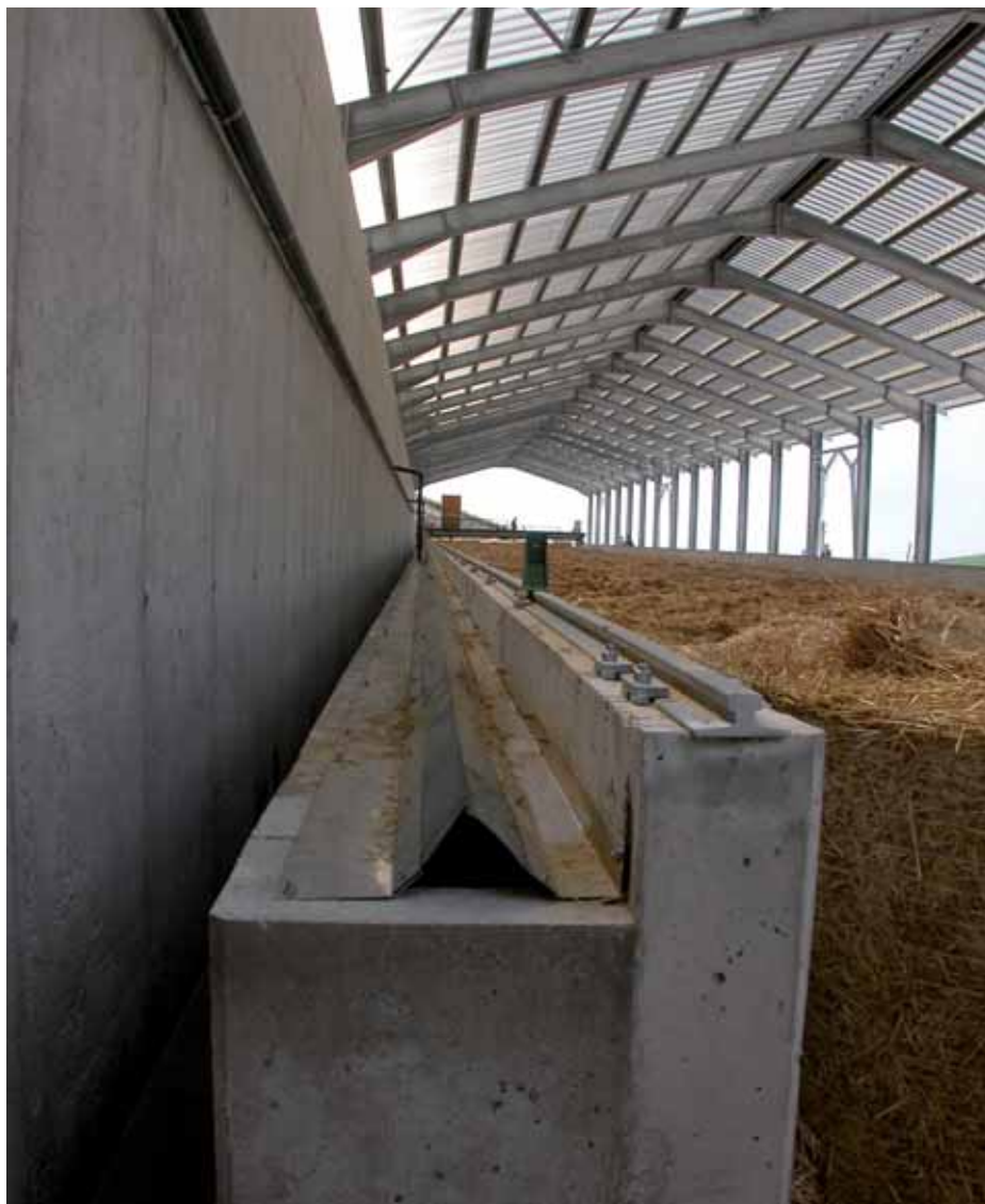
▼ Un particolare - ripreso dal lato opposto rispetto all'immagine precedente, della vasca con i liquami. È coperta per evitare la diffusione di odori.
